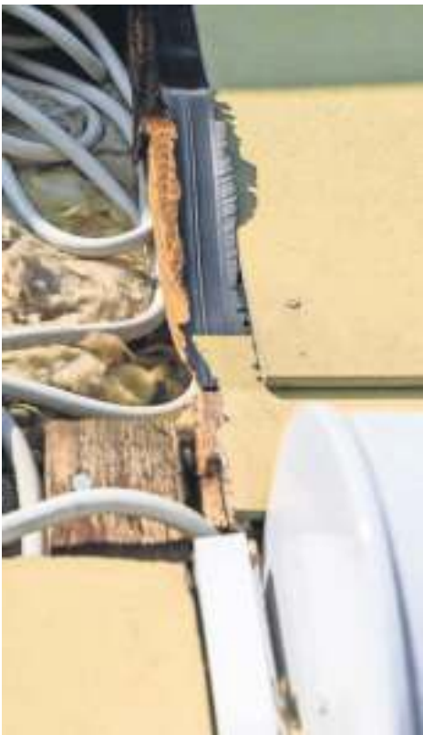
Was tun mit lockeren Asbestplatten?
