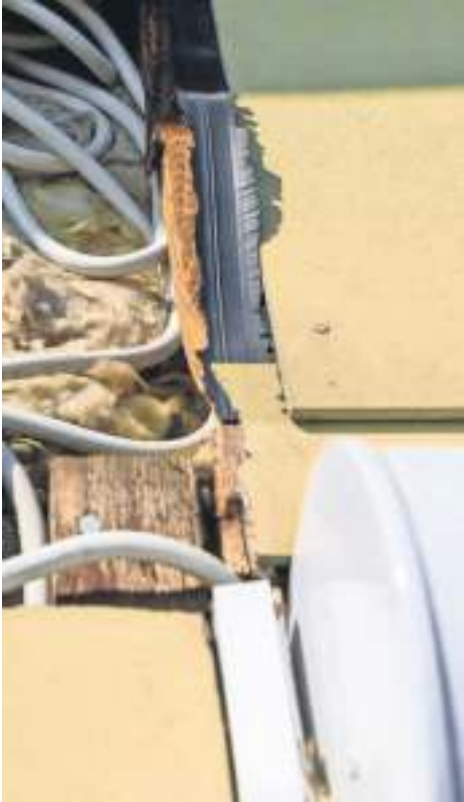
Was tun mit lockeren Asbestplatten?
