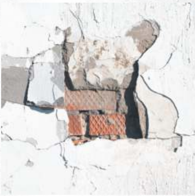
Das muss saniert werden: Ein abgeplatzter Putz ist häufig das Resultat von feuchten Wänden.
