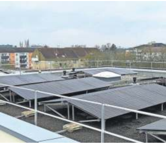
Beim Projekt in Hausen sind die Fotovoltaikanlage und der Batteriespeicher intelligent mit der Strom- und Wärmeversorgung gekoppelt.
