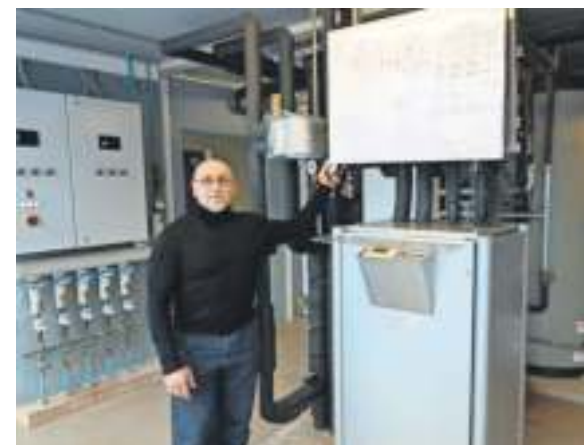
Matthias Siegle in seiner Energiezentrale. Fotos: Michael Käfer
