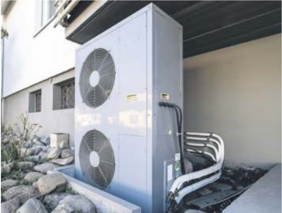
Fellbach setzt in seiner Wärmeplanung auf Wärmepumpen und Photovoltaik. Foto: dpa/Silas Stein
