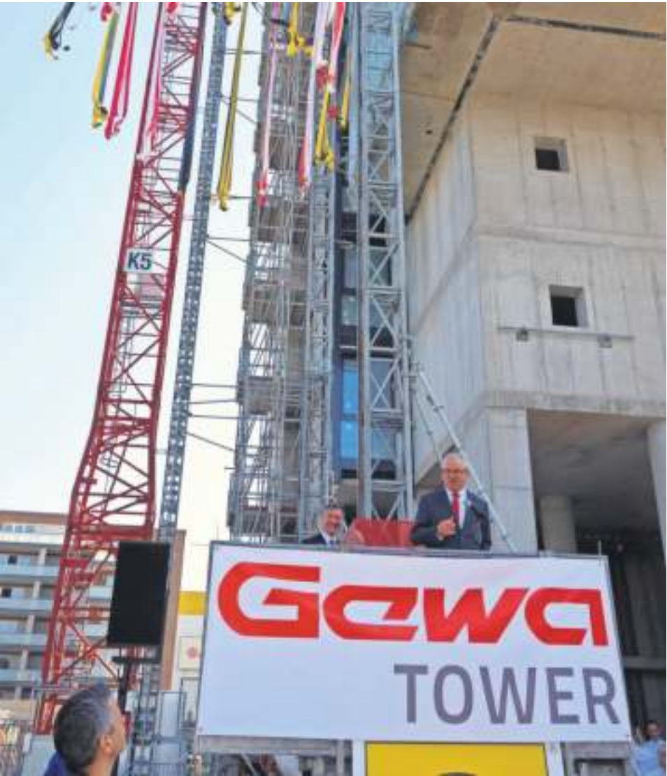
2014 wurde mit dem Bau des Gewa Towers begonnen und zwei Jahre später Richtfest gefeiert. Bis heute ist der 107 Meter hohe Turm eine Bauruine und mittlerweile ein negatives Wahrzeichen von Fellbach.
