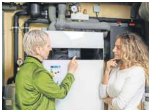
Fragen rund um die Wärmepumpe werden beim Infoabend geklärt.
