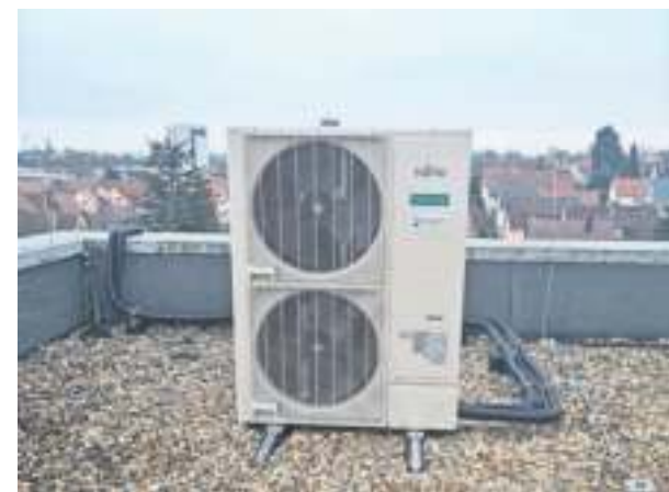
Außeneinheit eines großen Bürogebäudes.
