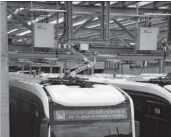
Auf dem Omnibusbetriebshof in Möhringen können pro Nacht nun 28 elektrische Busse geladen werden. (Foto: M. Celebil).
